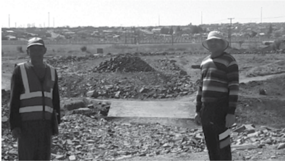
Op die foto vl: Desmond Adams en regs DA-raadslid Robert Ferendale by die verlate konstruksierrein.
